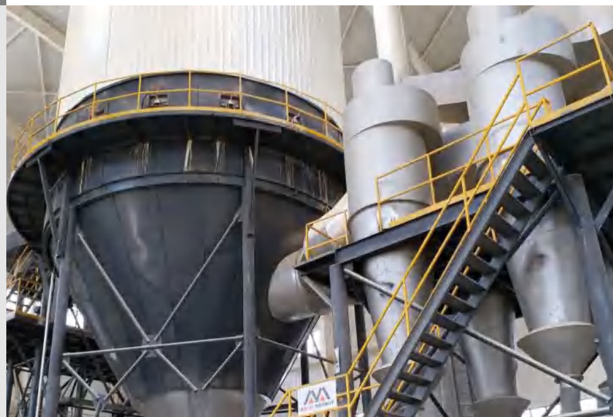
喷雾塔 | Spray Dryer
